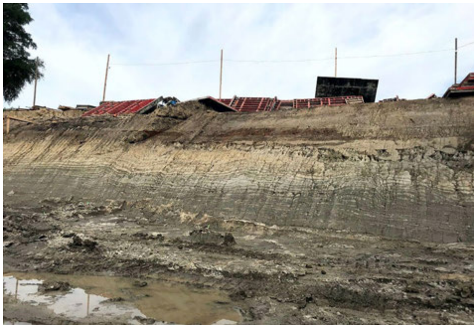
Ryc. 4. Iły warwowe w dolinie Junikowskiego Strumienia na obszarze budowy osiedla mieszkaniowego Stara Cegielnia (fot. M. Olkowicz)
